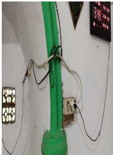
b. Kondisi awal instalasi
