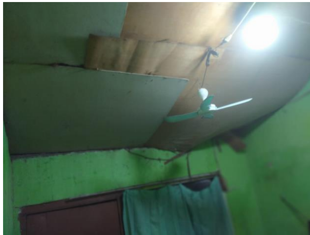
Gambar 4. Kondisi Plavon Rumah
