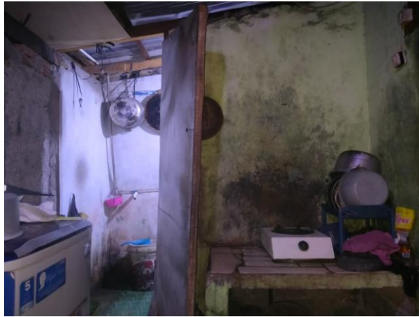
Gambar 1. Kondisi Kamar Mandi
